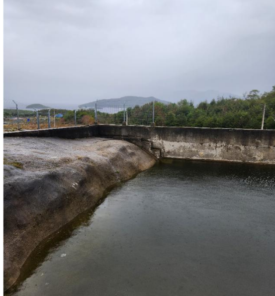
Ilustración 4. Estanques de almacenamiento de aguas lluvias para suministro de agua potable
