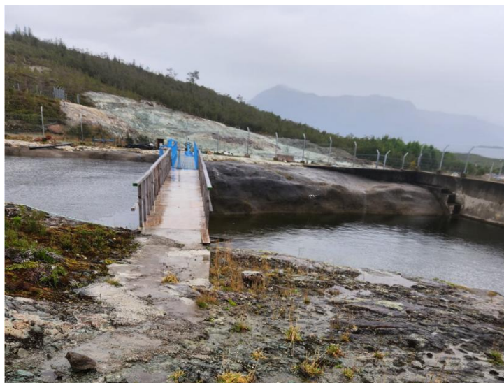
Ilustración 3. Estanques de almacenamiento de aguas lluvias para suministro de agua potable
