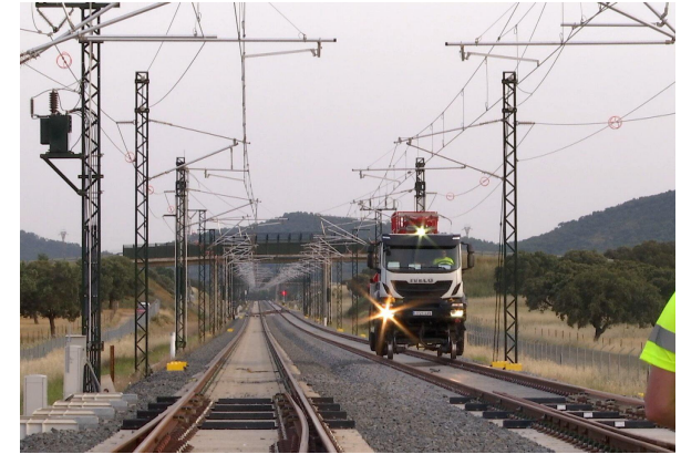
Electrificación de la red
